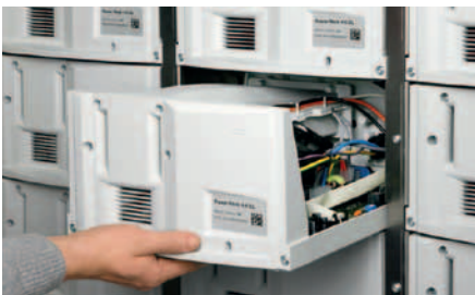
Modularer Aufbau der Leistungsteile beim CL
